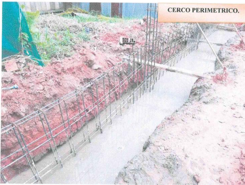
Fotografía N° 04: Vista fotográfica donde se aprecia el trabajo de vaciado de cemento corrido en cerco perimetrico.
