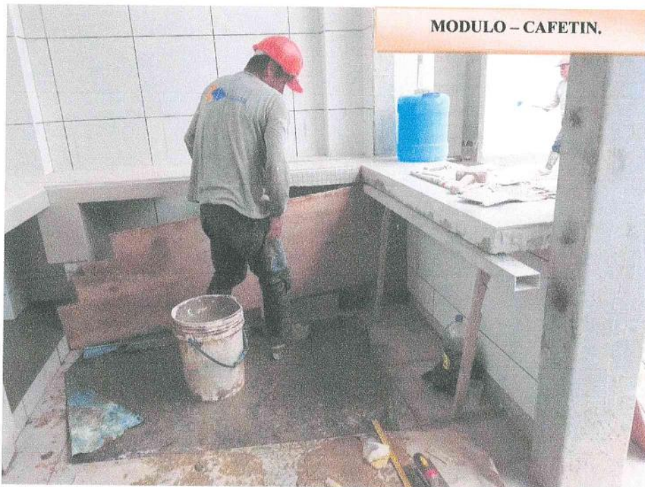
Fotografía N° 08: Vista fotográfica donde se aprecia el trabajo de colocación de mayólicas en mesadas de cafetin.
