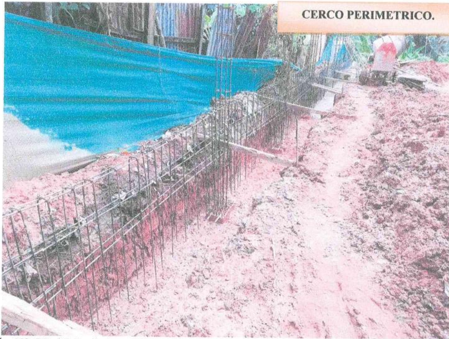
Fotografía N° 03: Vista fotográfica donde se aprecia el trabajo de colocación de acero en columnas y sobrecimientos para cerco perimetrico.
