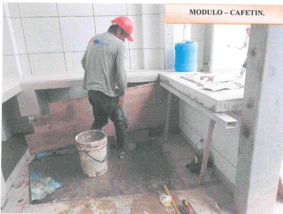
Fotografía N° 08: Vista fotográfica donde se aprecia el trabajo de colocación de mayólicas en mesadas de cafetin.
