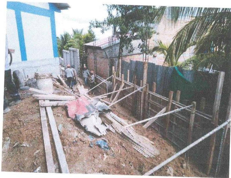
FOTO N° 10. ENCOFRADO DE SOBRECIMIENTO DE CERCO PERIMETRICO COLINDANTE AL AA. HH MALECON SHANUSI.
