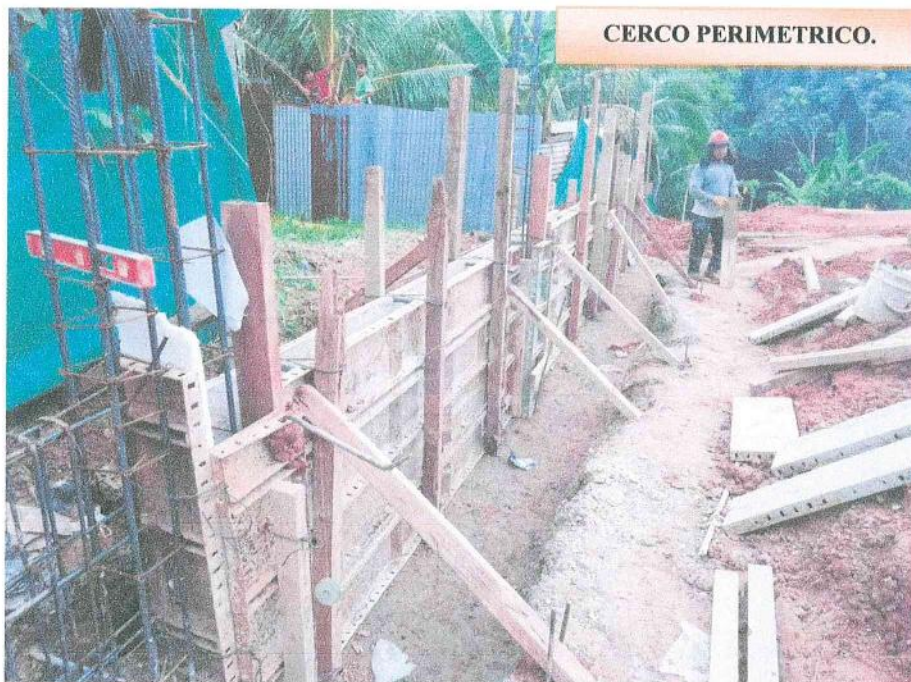
Fotografía N° 10: Vista fotográfica donde se aprecia el trabajo de encofrado de sobrecimiento en cerco perimetrico.
