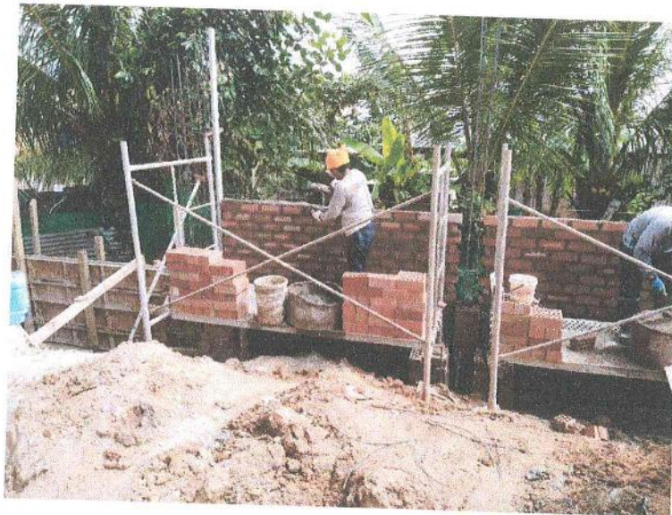
FOTO N° 09. ASENTADO DE LADRILLOS EN FORMA DE SOGA EN CERCO PERIMETRICO COLINDANTE AL AA. HH MALECON DE SHANUSI.
